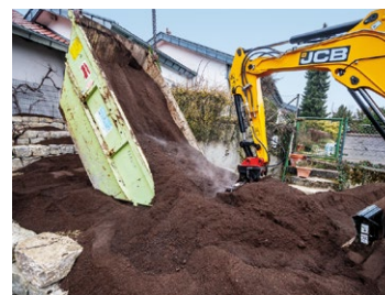
Schüttwerk: Vom Container geht's in den Garten.
